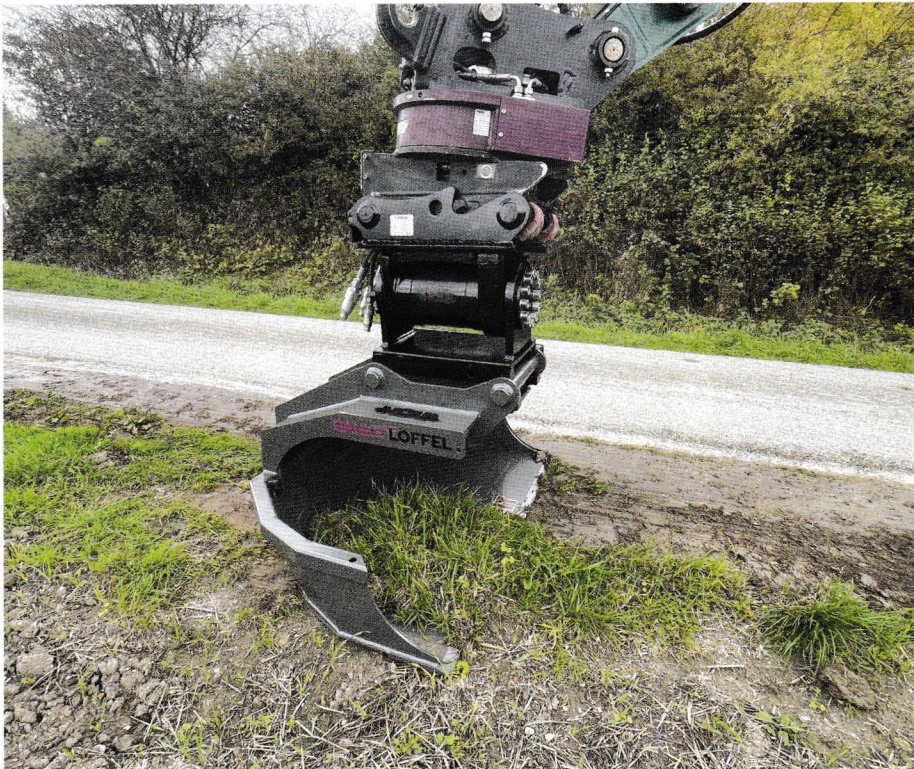
Gleichmäßig gepflegte Straßenränder vor, hinter und unter den Leitplanken: Dafür soll der Bankett-Löffel sorgen.
