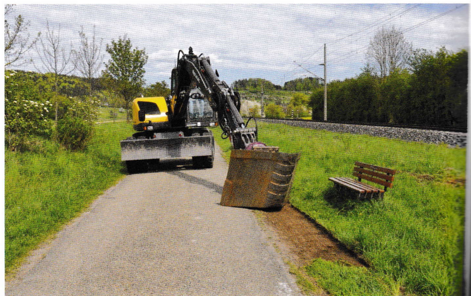
Ob Gräben erstellen und putzen oder Wege verdichten: Der Vario-Löffel ist laut Holp flexibel und steigert die Arbeitsleistung enorm.
