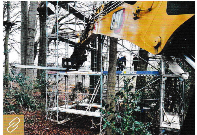
RotoTop macht den Bagger zum Schweizer Taschenmesser. So kann der Stahlträger aufgenommen und in mehreren Metern Höhe an der richtigen Stelle platziert werden. Bild: Holp
